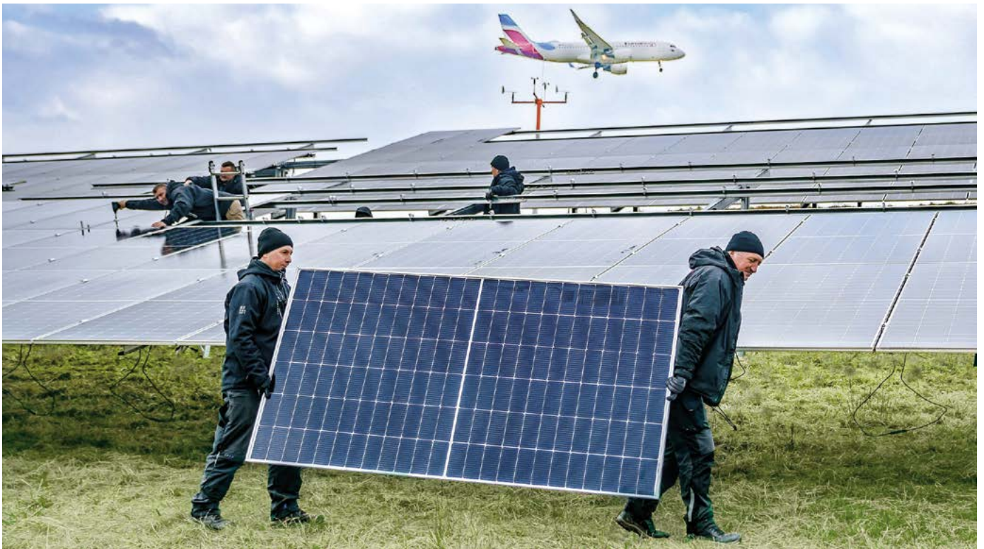
Der STR befindet sich auf dem Weg zum Solarflughafen. Bis 2040 sollen rund 30 Anlagen auf den Freiflächen und Dächern der Gebäude am Campus installiert werden.
