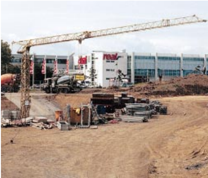
An der Südseite des Flughafens wird derzeit viel Erde bewegt – das neue Frachtzentrum entsteht
